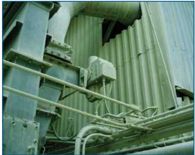
Kiln Reverse Air Fan Damper
